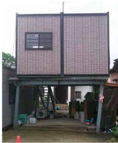
地震で曲がった駐車場の柱
